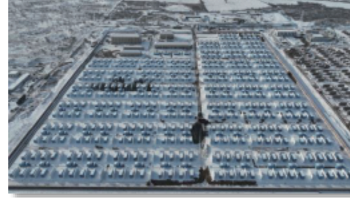
内蒙古海螺储能项目
