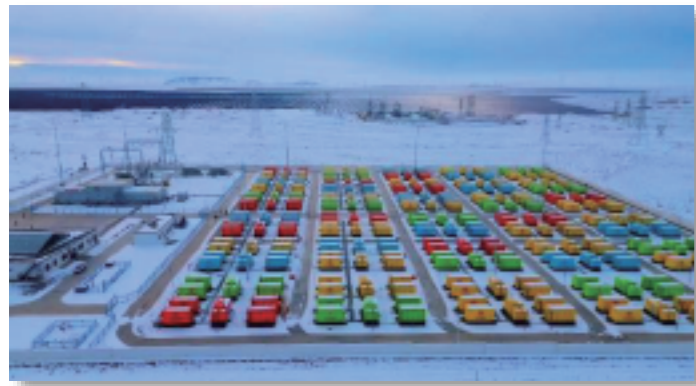
甘肃临泽板桥羊台山独立共享储能电站项目
