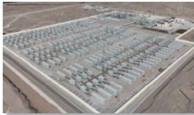
新疆克州独立储能项目一期
