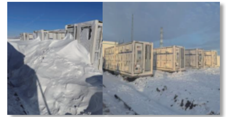
新疆塔城风电配储项目（零下30°C）
