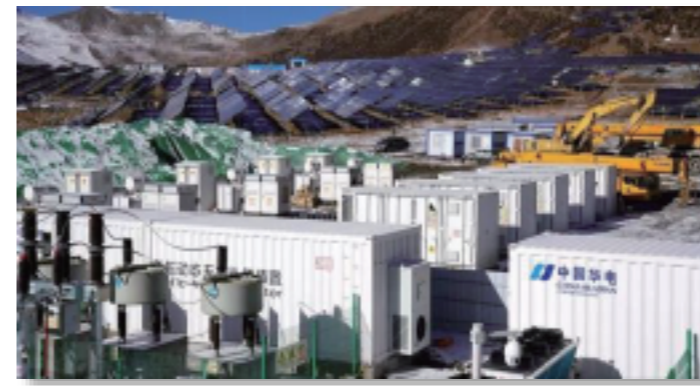
四川金川县光伏配储系统（海拔4385米）
